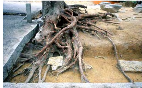
西塔基壇北東を侵すクスの根
