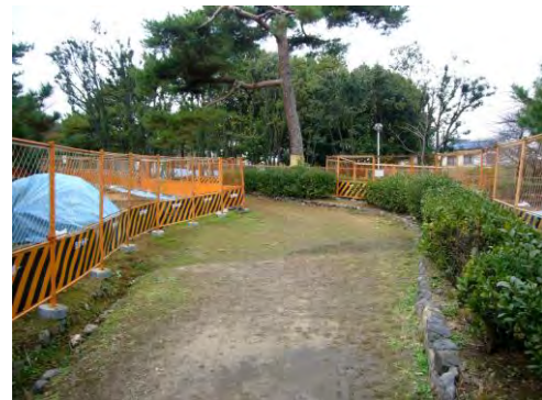
調査時の仮囲い状況（工事期間は搬入資材置場も含めて囲う必要あり）
