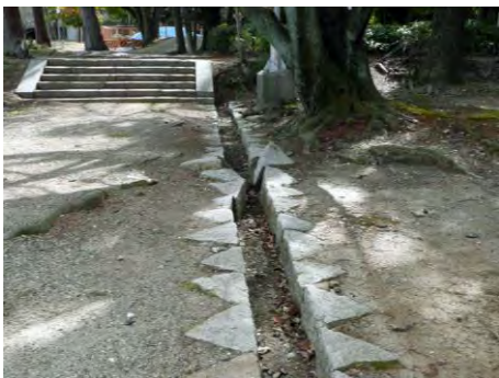
樹根による破損がみられる 間知石による排水路
