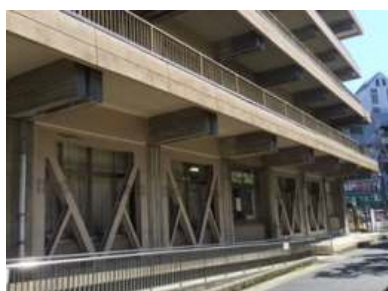
防災拠点としての耐震性の不足
