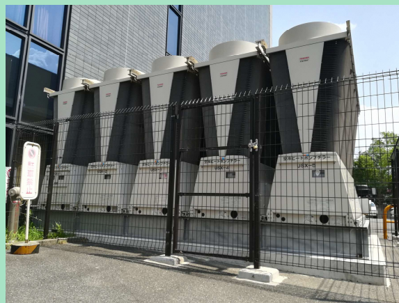
空調用熱源機（きらら）
