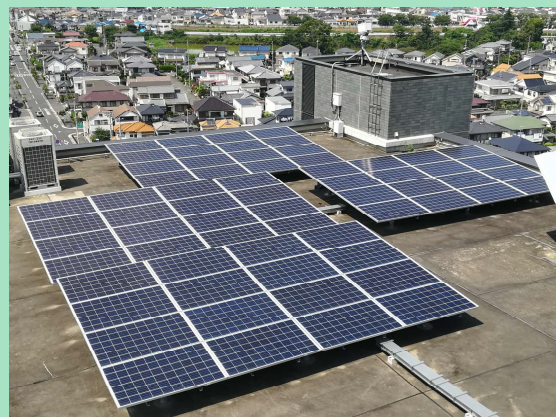
太陽光パネル 21.2kw（きらら屋上）
